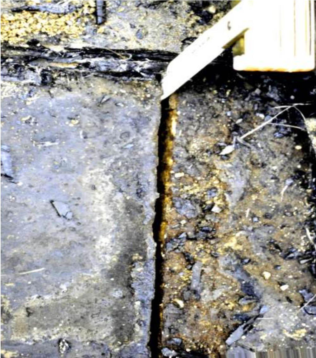
F05 - .....die Abdichtung aus Bitumenbahnen, über den Dehnungsfugen mit einer Kunststoffbahn verstärkt – gerissen!
