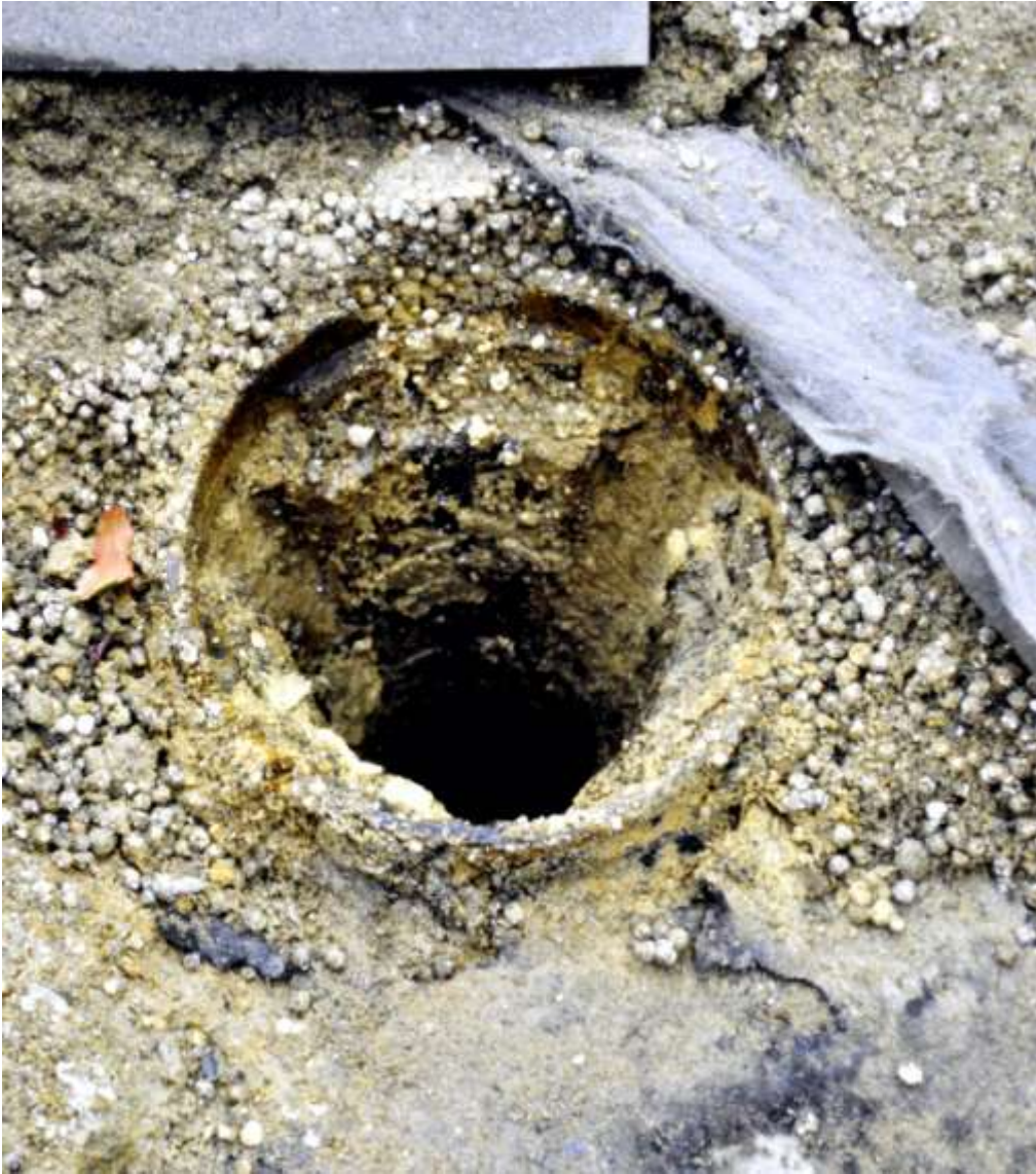
F06 - Die Dehnungsfugen verlaufen durch die Abläufe, deren (Ablauf)Nuten verstopft sind und das anstauende Oberflächenwasser gelangt durch die Rissstellen der Abdichtung, die Fugen ins Innere.
