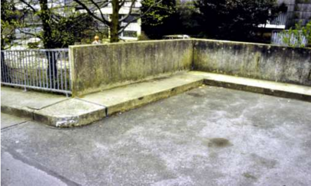
F09 - Fertigteilkonstruktion – Schrammboard, Attika, befahrbarer Nutzbelag mit Rissen
