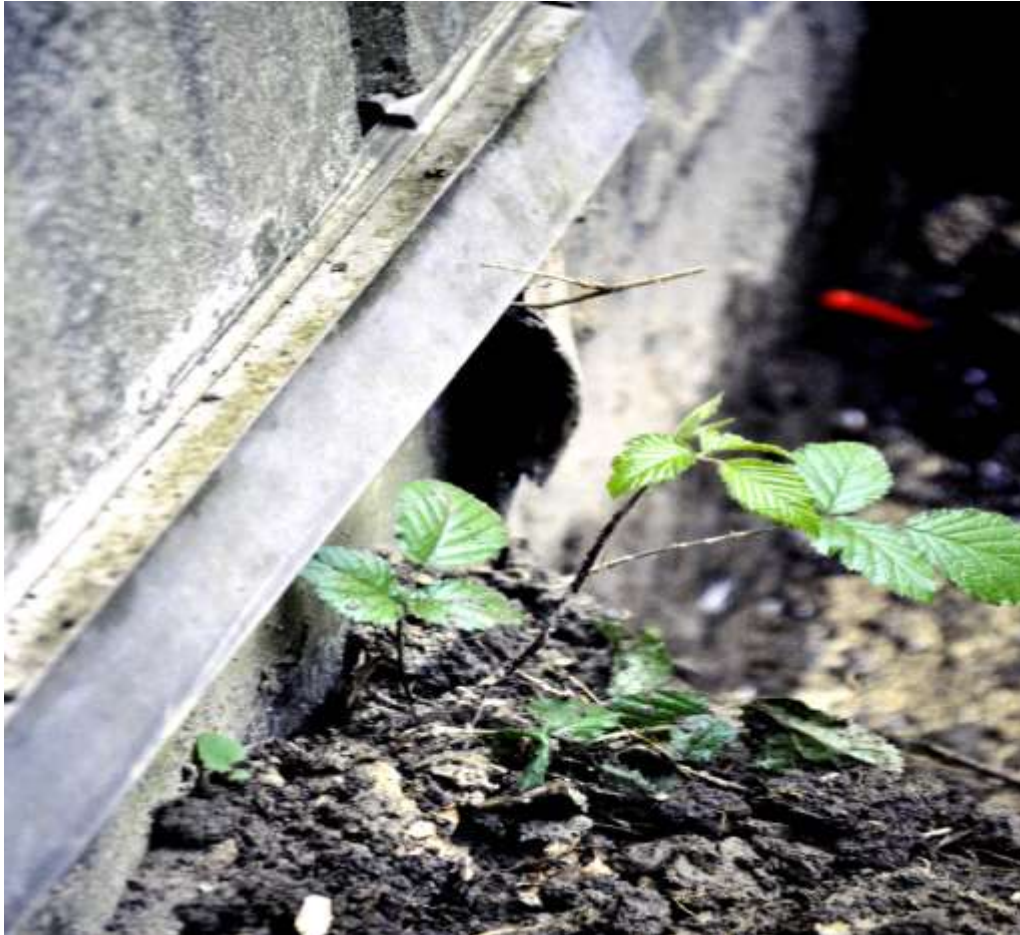
F07- Abdichtung der aufgehenden Bauteile mit einer Bitumenbahn mit Aluminium-Bandeinlage – mit offenen Nähten (u.a. durch die thermische Längenänderung. Bausünden in Serie!!
