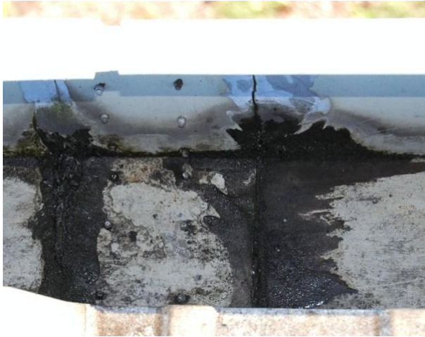
Abb. 10: Auch die Notabdichtung dieser großformatigen Dachrinne ist keine dauerhafte Lösung. (Foto: Jürgen Lech, BFD Essen)
