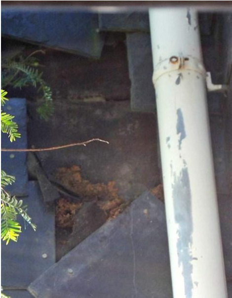
Abb. 5: Als Folge der Durchfeuchtung wurde die Unterkonstruktion massiv geschädigt, Schieferplatten verschoben sich und fielen herab. (Foto: Jürgen Lech, BFD Essen)
