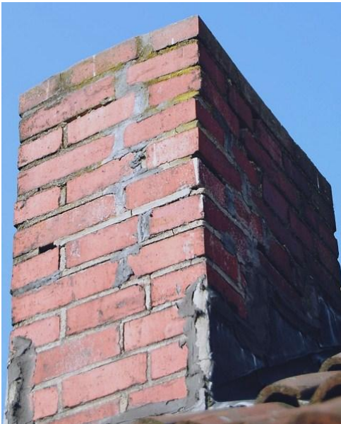
Abb. 6: Der Kaminkopf hat sichtbar Wasser aufgenommen. Hier ist eine Bekleidung notwendig. (Foto: Jürgen Lech, BFD Essen)
