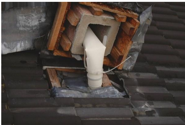
Abb. 3: Hier fehlte sichtlich ein kraftschlüssiger Verbund zum Untergrund. (Foto: Jürgen Lech, BFD Essen)
