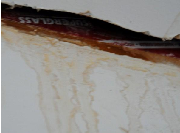
Abb. 1: Spuren des ablaufenden Wassers. Die Dampfsperre haftet nicht an der Pfette. (Foto: Jürgen Lech, BFD Essen)
