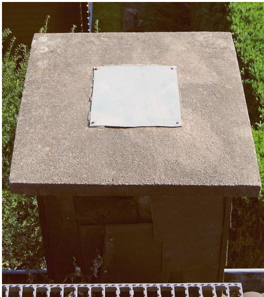
Abb. 4: Über die Dachrinne drang Wasser durch die Beton- und die Blechabdeckung sowie die Fuge unter der Abdeckung ein. (Foto: Jürgen Lech, BFD Essen)
