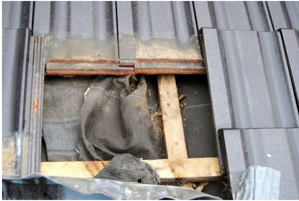
Abb. 12: Als Zusatzmaßnahme wurde eine Unterspannung eingebaut, aber nicht dicht verlegt und angeschlossen. Sie ist somit wirkungslos. (Foto: Jürgen Lech, BFD Essen)
