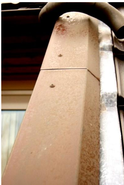
Abb. 8: Zu gering überdeckt, zu lang, nicht ausreichend angeformt – Mangel? (Foto: Jürgen Lech, BFD Essen)
