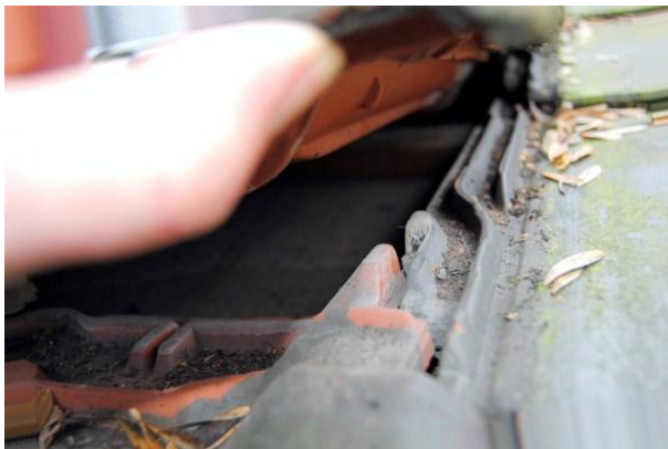
Abb. 11: Bei flachen Dachneigungen, hier ca. 9 Grad, tritt Wasser/Schnee durch die Verfaltung ein. (Foto: Jürgen Lech, BFD Essen)
