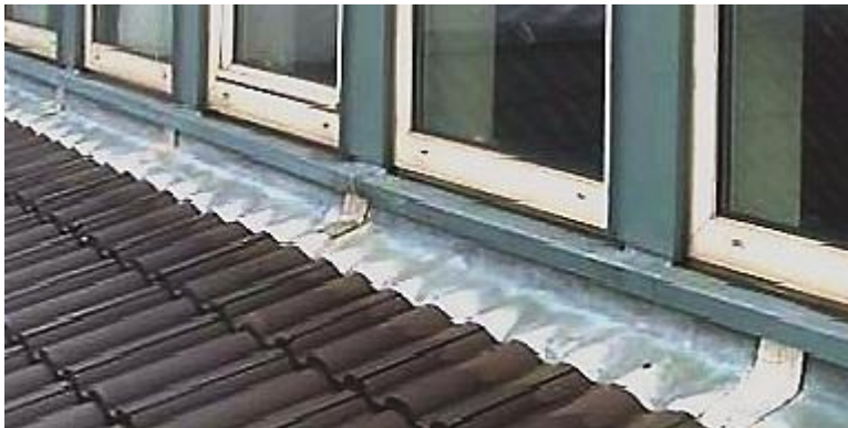
Abb. 7: Die Abbildung zeigt ein erst fünf Jahre altes Dach mit Meterstreifen an den Gauben, der mit Reparaturband abgeklebt ist – Soll-Zustand? (Foto: Jürgen Lech, BFD Essen)
