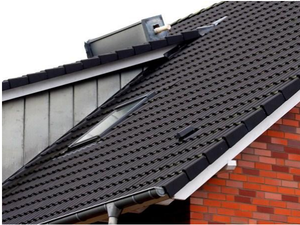
Abb. 2: Kaminkopf liegt auf dem Dach. (Foto: Jürgen Lech, BFD Essen)
