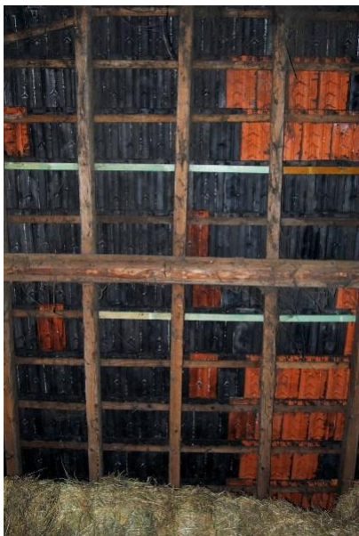
Abb. 13: Hier wurde die Dachdeckung ohne Zusatzmaßnahme verlegt. Das führte dazu, dass die Traglattung verfaulte und die Dachziegel abrutschten. Sturm war nicht die primäre Ursache. (Foto: Jürgen Lech, BFD Essen)
