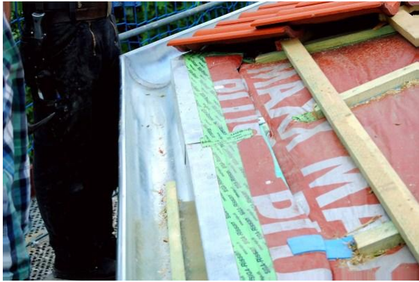
Abb. 14: Hier liegt der Soll-Zustand vor: Unter der Traufe ist die in der Überlappung verklebte Unterspannung verlegt, mit blauen Nageldichtbändern unter den Konterlatten. (Foto: Jürgen Lech, BFD Essen)
