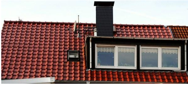
Abb. 17: Neue Dachdeckung mit Verfaltung, aber ohne Leiterhaken. Hier können spätere Reparaturen teuer werden und es droht Absturzgefahr. (Foto: Jürgen Lech, BFD Essen)
