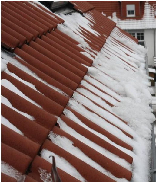
Abb. 16: Entwässerungseinrichtungen können im Winter zufrieren, wenn Niederschläge z. B. bei innenliegenden Dachrinnen aufstauen. (Foto: Jürgen Lech, BFD Essen)
