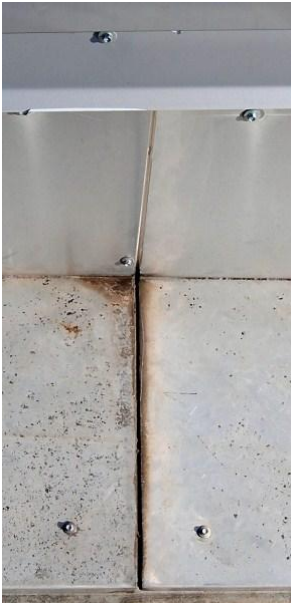
Abb. 9: Gekantet, kraftschlüssig verschraubt und aufgewellt – keine dauerhafte Lösung! (Foto: Jürgen Lech, BFD Essen)
