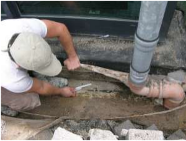
Abb. 3: Anschluss einer WUD-Betondecke mit Flüssigkunststoff (gerissen!), PVC- und EPDM-Anschlussstreifen an die Fenster – drei Systeme, keine ausreichende Verbindung, keine Gewährleistung (Foto: Lech)
