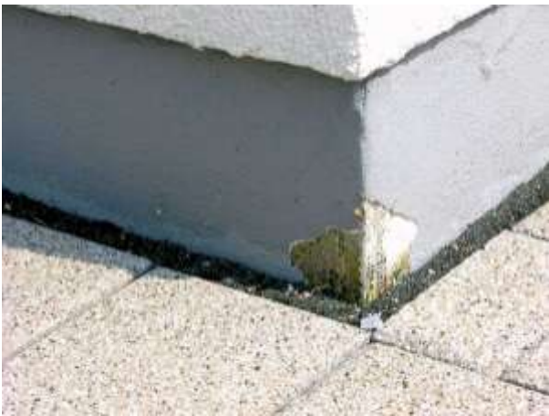
Abb. 5: Schaden durch aufsteigende Feuchte im WDVS – geplanter Mangel? (Foto: Lech)
