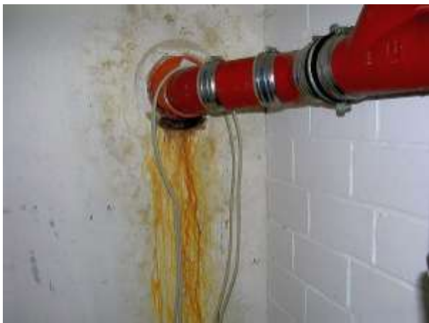
Abb. 1: Die Mängel werden oft zu spät erkannt und ignoriert – Wasser tritt durch die Außenwand in eine Tiefgarage ein – Rohrleitung mit Korrosion (Foto: Lech)
