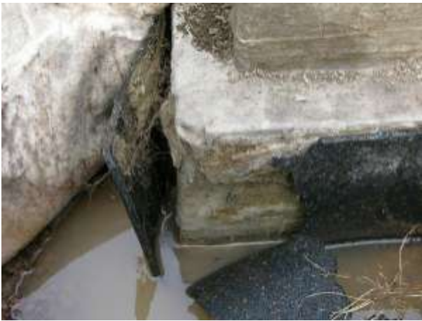
Abb. 4: Geplant war eine Abdichtung gegen nicht drückendes statt anstauendes Wasser (Foto: Lech)
