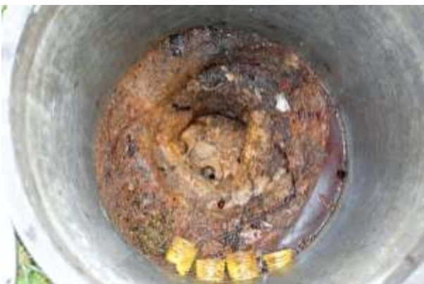
Abb. 10: Einschränkung der Entwässerung durch Versinterung, Auswaschungen aus den „ungeschützten“ Oberflächenbelägen (Foto: Lech)
