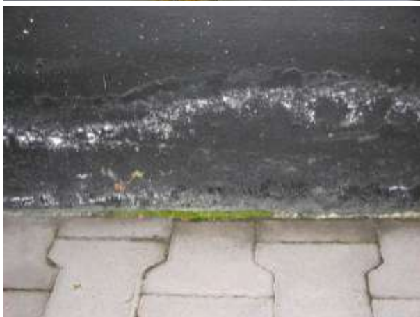
Abb. 2: Am Bauteil aufgehende Abdichtung – ohne Entwässerung, mit sichtbarer Wasserbelastung und Vermoosung des Belags (Foto: Lech)
