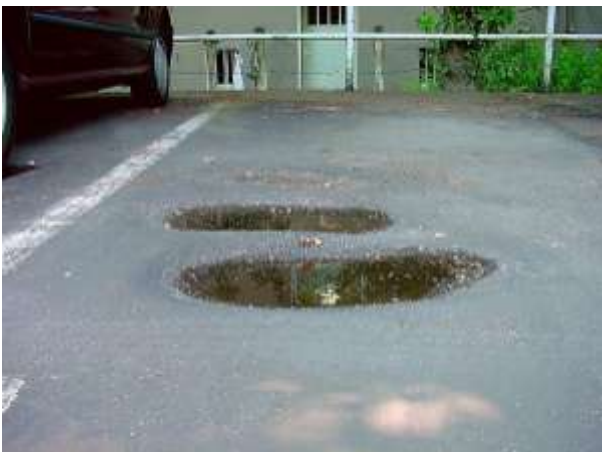
Abb. 6: Befahrene Abdichtung aus Gussasphalt mit bleibenden Eindrücken (Foto: Lech)
