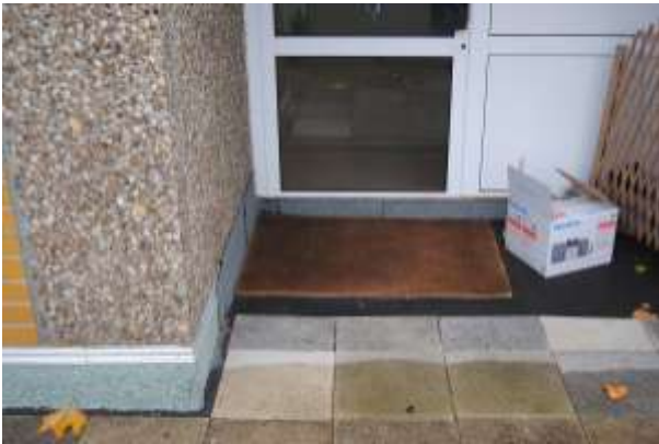
Abb. 8: Erneuerte Bauwerksabdichtung mit Mängeln – die hochgeführte Abdichtung ist nicht geschützt, es sind keine ausreichenden Anschlusshöhen vorhanden, Abdichtung auf Vorsatzschale, keine Entwässerung (Foto: Lech)
