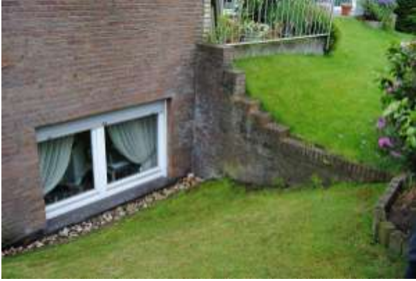
Abb. 7: Missglückter Versuch der Teilsanierung einer vertikalen Bauwerksabdichtung – ohne ausreichende Entwässerung, Abdichtung auf die Klinkerschale geführt, kein dichter Anschluss an die Altabdichtung (Foto: Lech)
