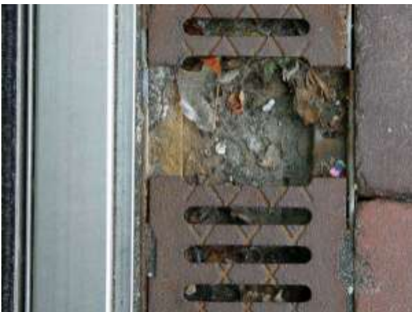
Abb. 9: Wartung erforderlich – verdreckte und nicht angeschlossene Rinne (Foto: Lech)
